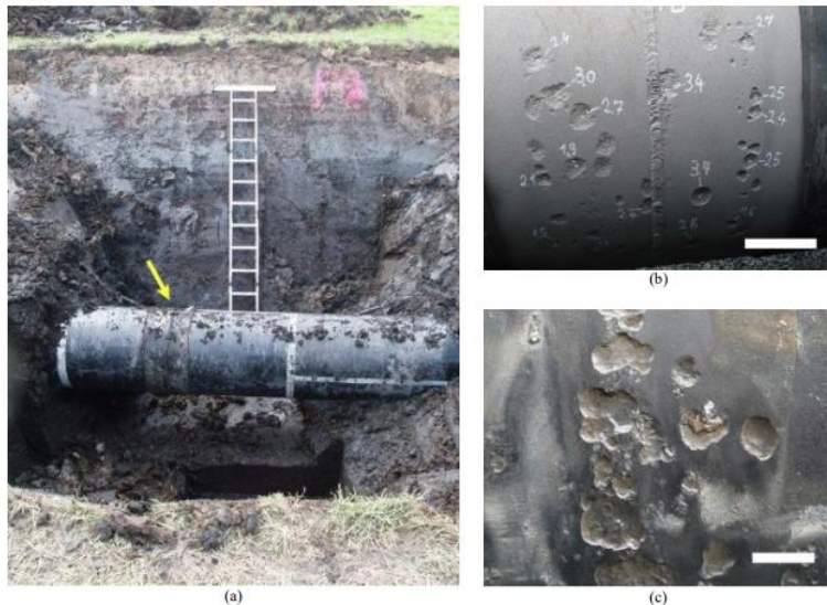
Gambar 4.5. Pipa transmisi gas ini tertanam di tanah rawa. Pipa terlihat terbungkus oleh lapisan aspal (a). bentuk korosi akibat MIC (b). bentuk korosi akibat MIC dengan pembesaran yang lebih tinggi (c). [Ahmad royania, dkk, 2021]
