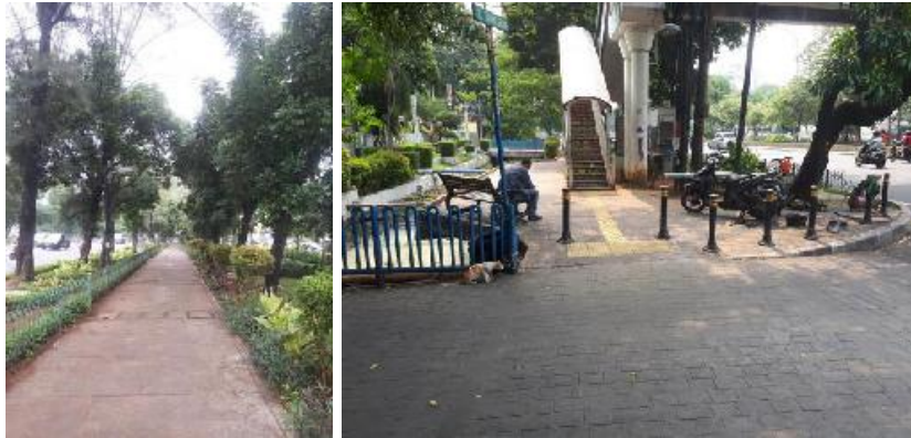
Gambar 8 Kerusakan Elemen Pelengkap Jalur Pejalan Kaki (Dokumentasi Pribadi 2022)
