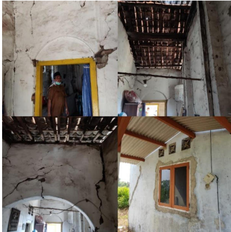
Gambar 2 Retak dinding rumah penduduk Kelurahan Bendung
