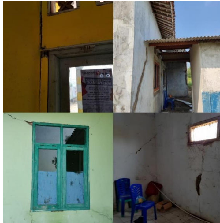
Gambar 3 Retak dinding kantor Kelurahan Bendung
