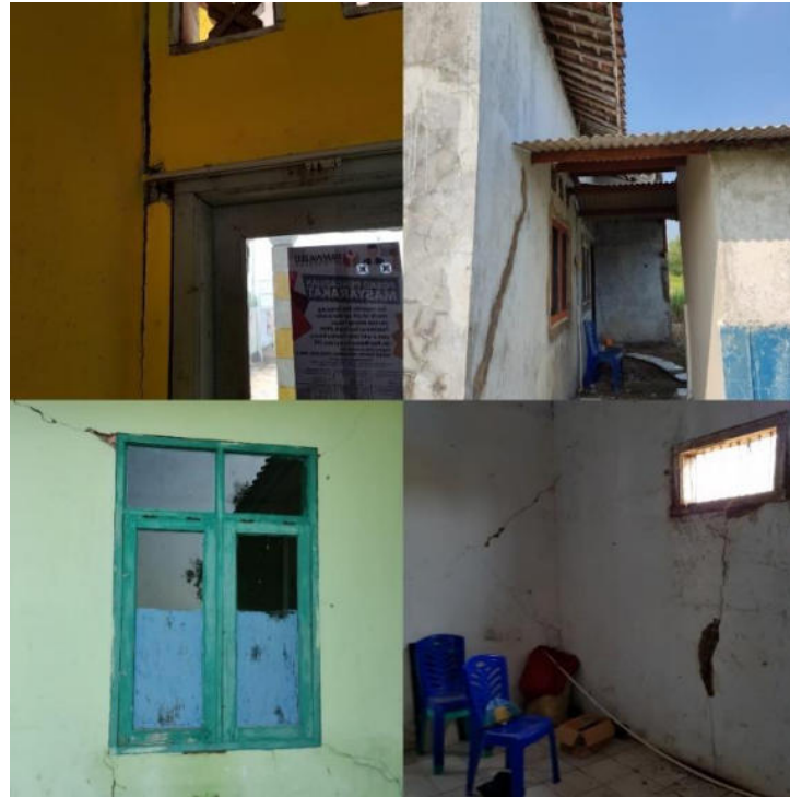
Gambar 3 Retak dinding kantor Kelurahan Bendung
