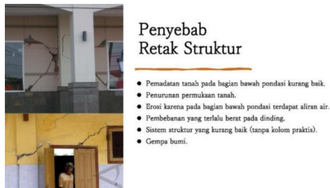
Gambar 5 Penyebab retak struktur pada dinding
