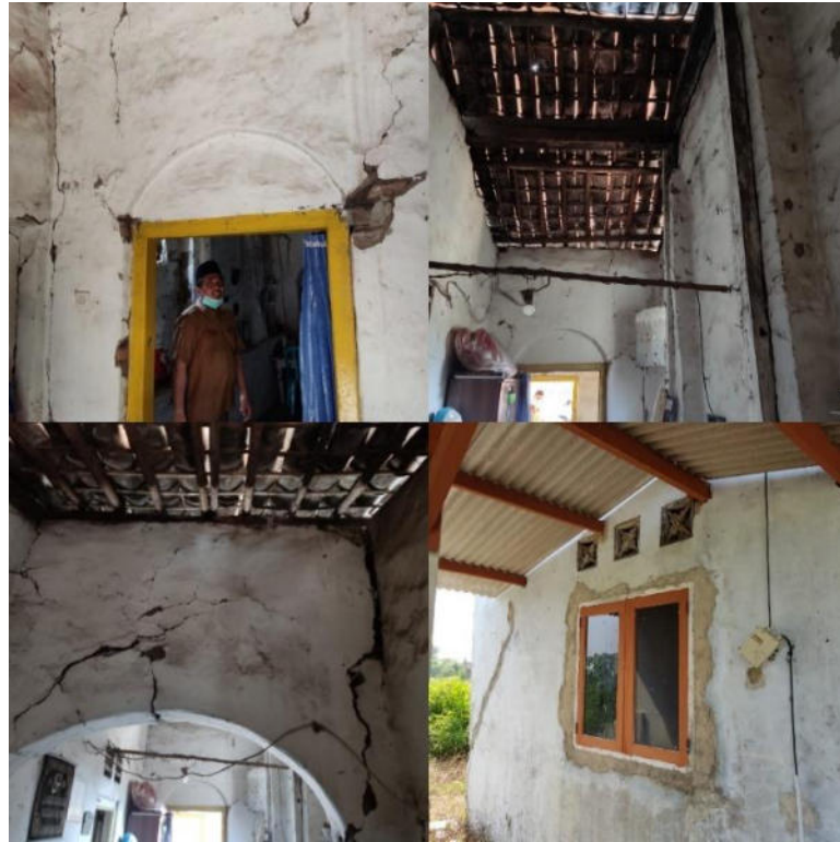
Gambar 2 Retak dinding rumah penduduk Kelurahan Bendung
