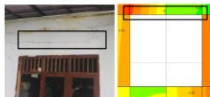
Gambar 9. Perbandingan kerusakan di tampak elevasi 3 (jendela kiri)
