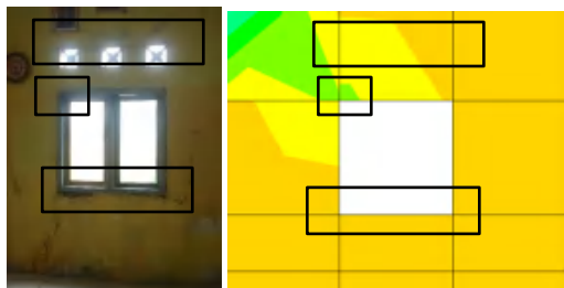
Gambar 7. Perbandingan kerusakan di tampak elevasi F
