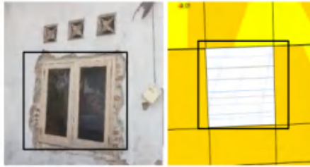
Gambar 11. Perbandingan kerusakan di tampak elevasi 8 (jendela kiri)
