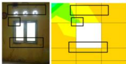
Gambar 7. Perbandingan kerusakan di tampak elevasi F
