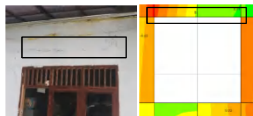
Gambar 9. Perbandingan kerusakan di tampak elevasi 3 (jendela kiri)
