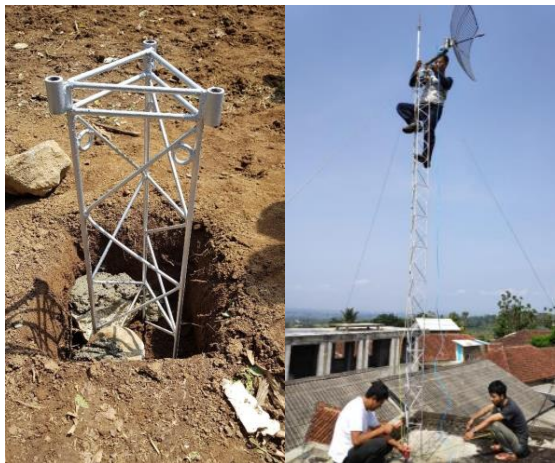
Gambar 4. Tower yang digunakan untuk jaringan
