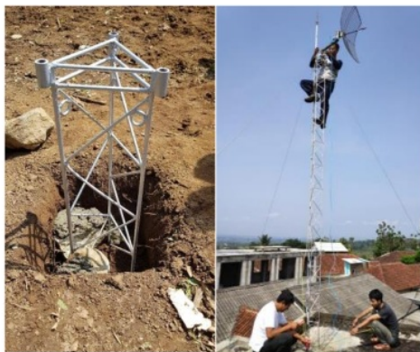
Gambar 4. Tower yang digunakan untuk jaringan
