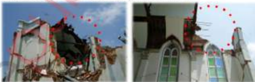
Gambar 5.6. Kerusakan pada beberapa bagian bangunan Kapel St. Leo
