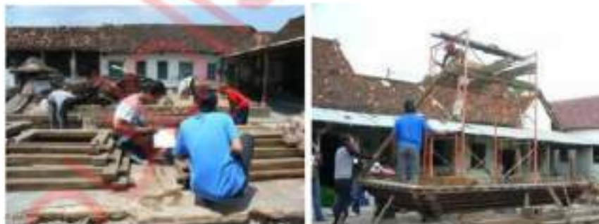
Gambar 10.13. Pengukuran detail untuk rumah Edy Priyanto di Desa Jagalan. Pada saat pengukuran bangunan yang roboh, perlu pula diperkirakan posisi komponen bangunan yang satu dengan yang lainnya (Sumber foto: Pusaka Jogja Bangkit!).
