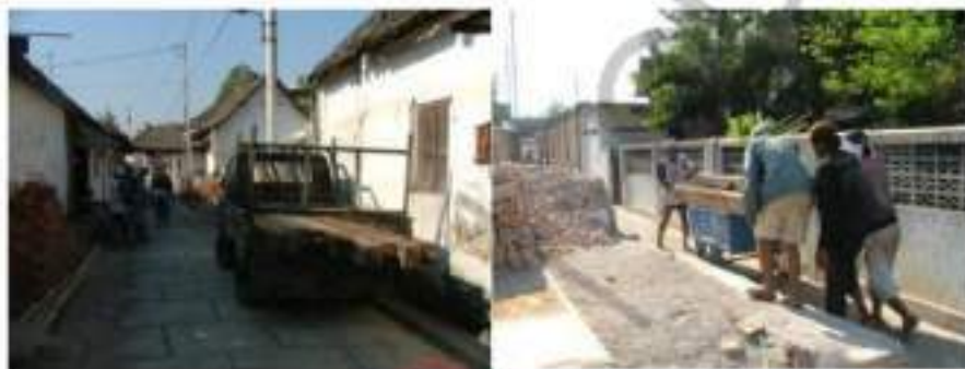
Gambar 5.8. Penjualan rumah tradisional yang rusak atau ambruk terjadi di Kotagede. Rumah-rumah tersebut ada yang dijual tidak berupa bangunan, tetapi materialnya
