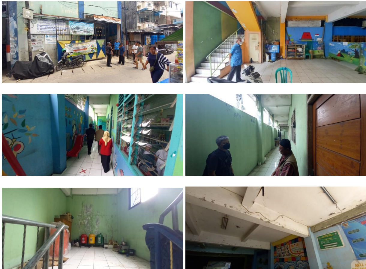
Gambar 1 : Kondisi Bangunan Sekolah di RW 02, Kelurahan Krendang
