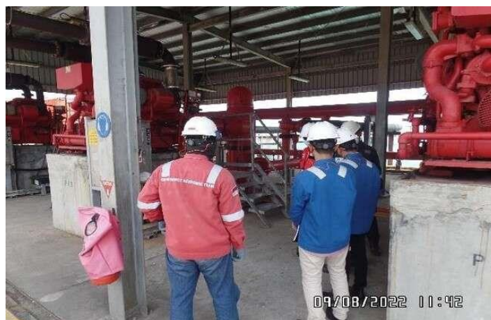
Gambar 1.5 Fasilitas Fisik Fire Pump
