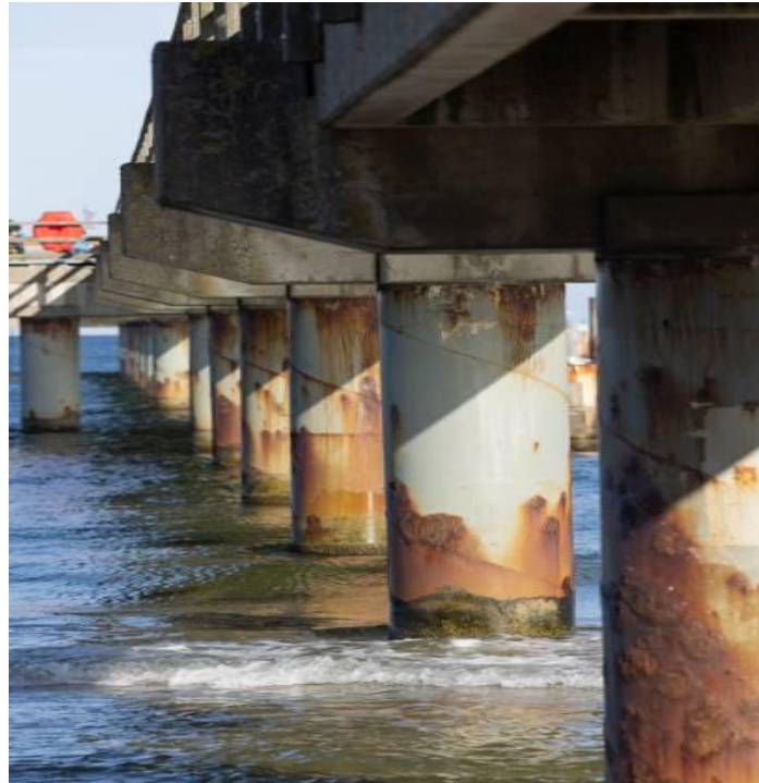
Gambar 2.1 Korosi Pada Splash Zone di Tiang Pancang Lepas Pantai
