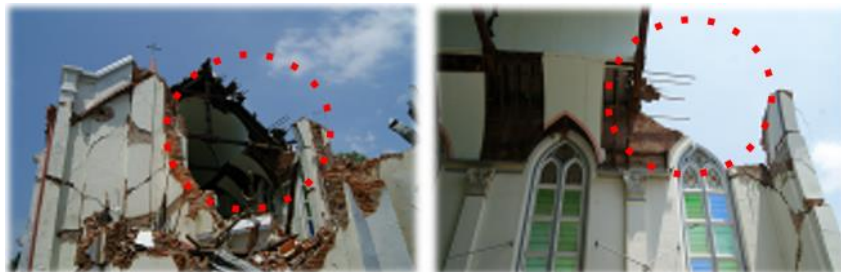
Gambar 5.6. Kerusakan pada beberapa bagian bangunan Kapel St. Leo
