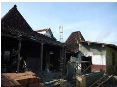
Gambar 5.11. Pembangunan rumah dengan Bantuan Dana Rekonstruksi mengakibatkan pembangunan yang tidak sesuai dengan kondisi eksisting bangunan tradisional.
