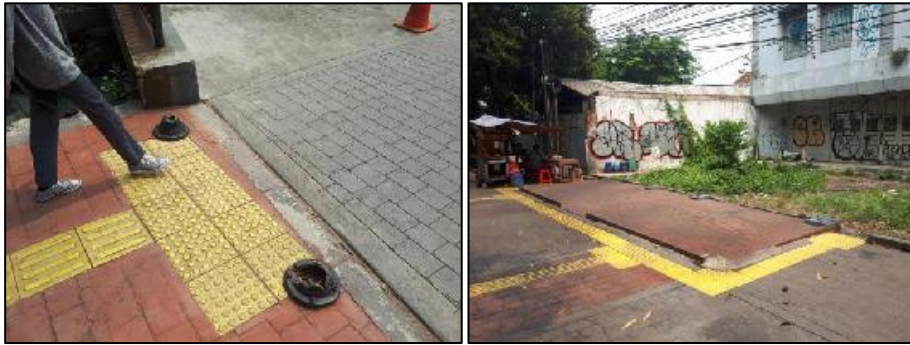
Gambar 6 Kerusakan Elemen Pelengkap Jalur Pejalan Kaki (Dokumentasi Pribadi 2022)
