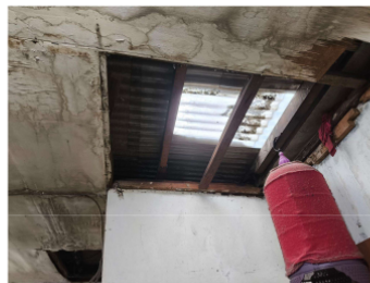
Gambar 14. Tampak atap bolong dan terlihat genteng bahan asbes
