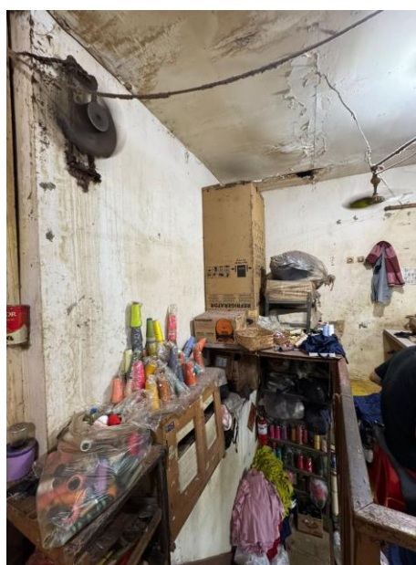
Gambar 11. Tampak tumpukan barang disisi kiri lantai 2
