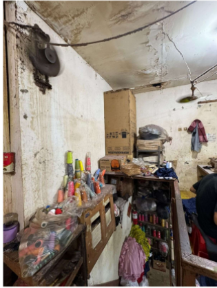
Gambar 11. Tampak tumpukan barang disisi kiri lantai 2
