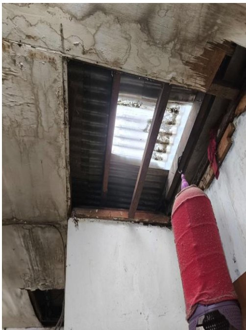
Gambar 14. Tampak atap bolong dan terlihat genteng bahan asbes
